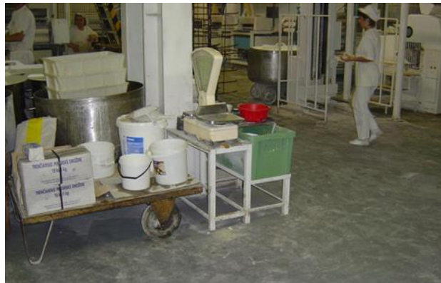
Vysoko odolná podlaha – pekáreň.
